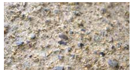
Bakterierisiko på betong
